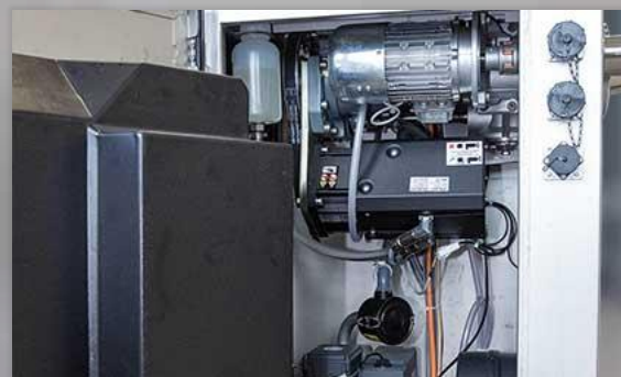
Bien accesible para facilitar el mantenimiento
